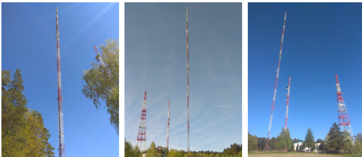
Widok obiektu wraz z zainstalowanym zespołem antenowym
